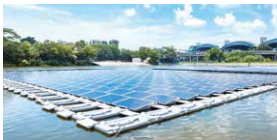
Instalaciones fotovoltaicas flotantes
